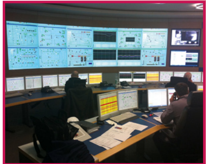
Abb. 1: Leitstand eines modernen Kraftwerkes mit SPPA-T3000
